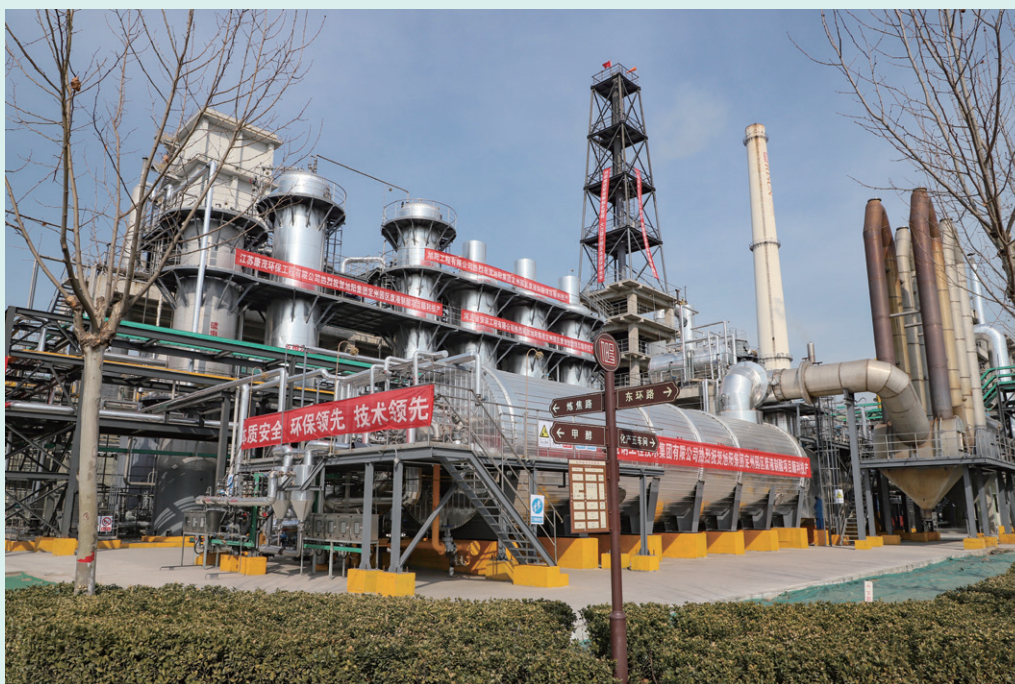
圖5-7 脫硫廢液制酸設備
